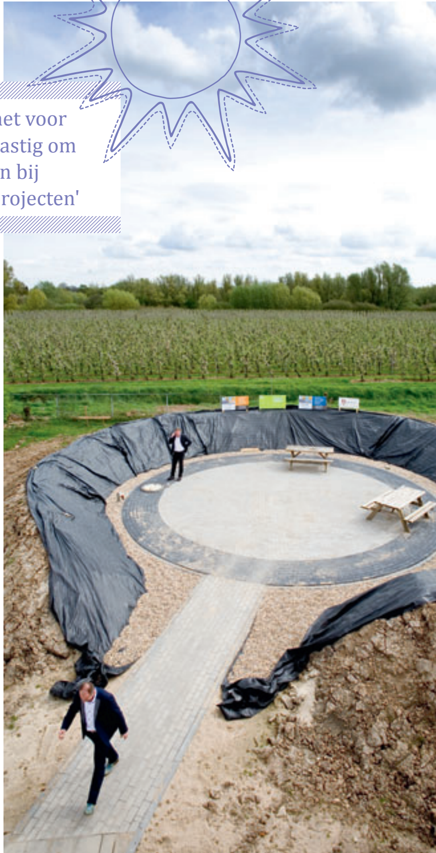
De warmte wordt opgeslagen in de SolarEis-buffer die is ingegraven in een kuil met een diameter van 10 m naast het gebouw.
